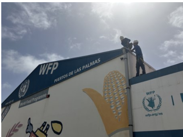
Pie de foto 2: ©WFP — Trabajos de reparación en cubierta de ITYP A III
