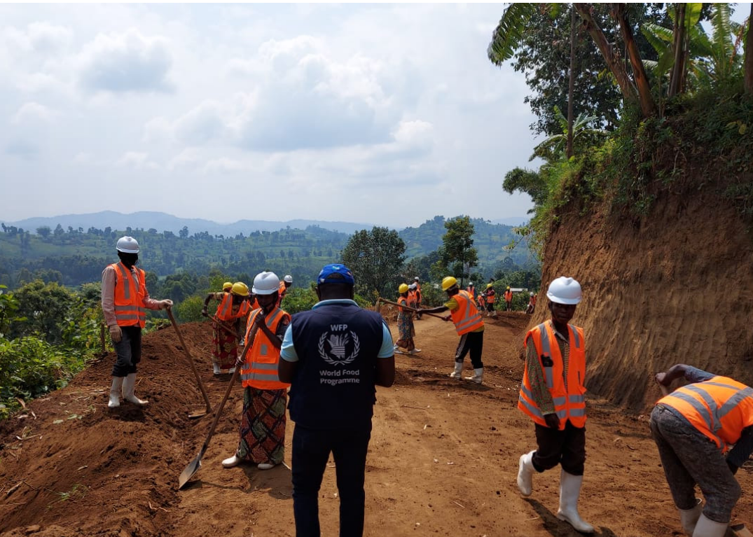
أفراد المجتمع المحلي يقومون بأعمال إعادة تأهيل الطرق في كيفو الشمالية، الصورة: البرنامج/الفريق الهندسي في جمهورية الكونغو الديمقراطية
